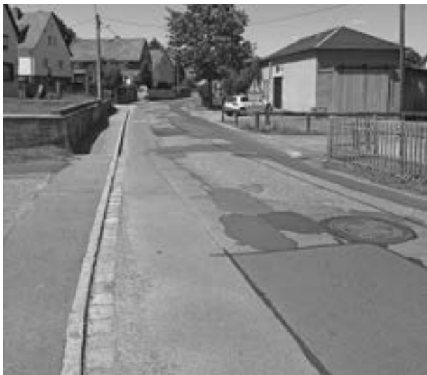
Zustand Hauptstraße Langebrück am Spritzenhaus
